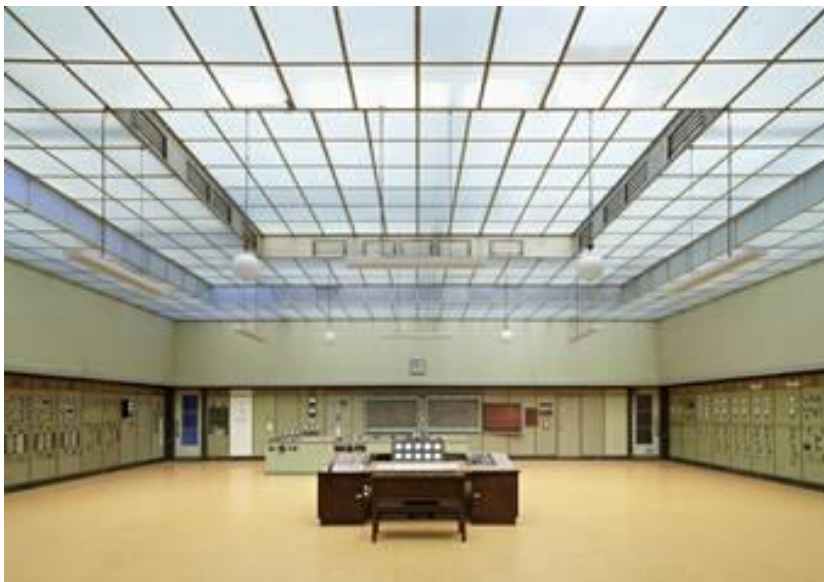
Kraftwerk Mitte (Schaltwarte) [Heizkraftwerk Mitte] Kraftwerk Mitte 1 – 32, 01067 Dresden Aufn.: Bertram Kober/punctum, 2013
