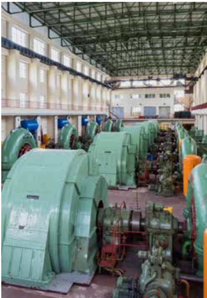
Inneres des Maschinenhauses mit Pumpspeichersätzen
